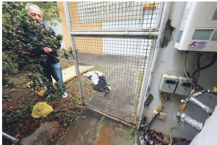
Bandidos arrombaram área onde fica sistema de aquecimento.
