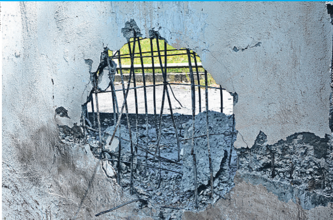
Portando armas pesadas e explosivos, marginais detonaram o muro e abriram passagem pros detentos.
