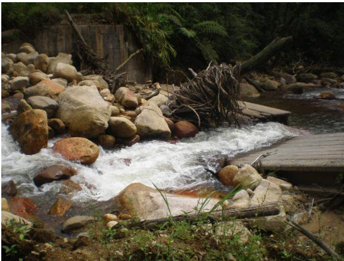
Figura 2.12 – km 15,0 do início mostrando ponte danificada pelas enchentes, sentido norte – sul
