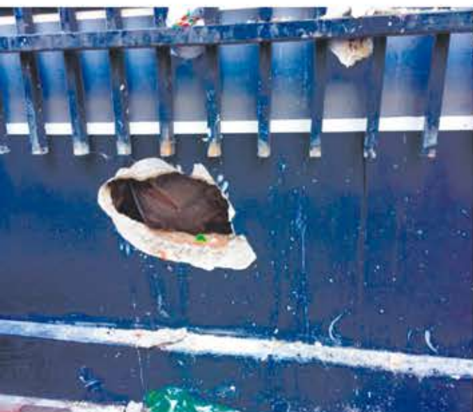
Detentos abriram buraco no banheiro.
